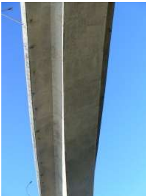
Laje caixaão vão 12 com armadura exposta junto lateral direita
