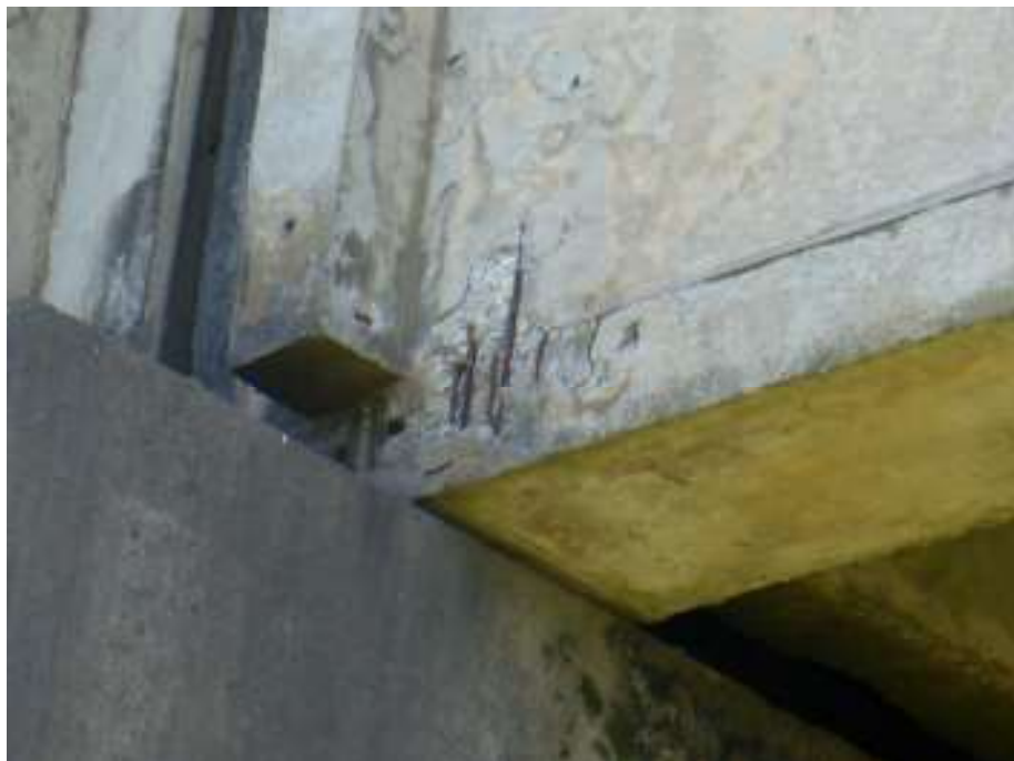
Armadura exposta V0001 sobre P0100 face esquerda
