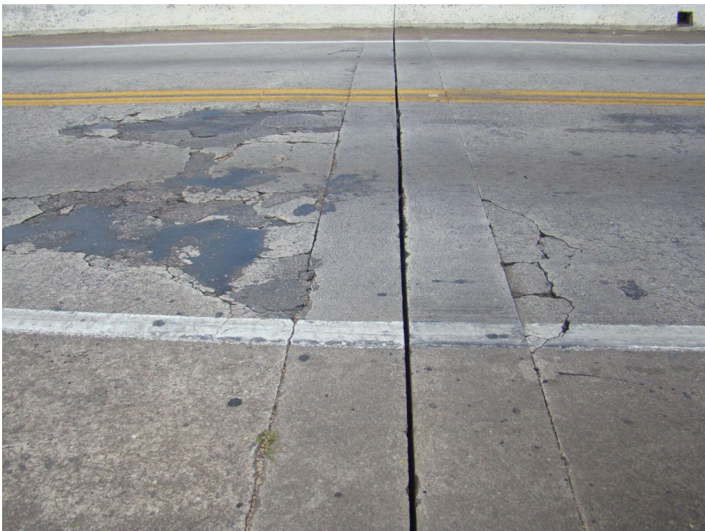
Figura 7 – Trincamento e desagregação na laje
