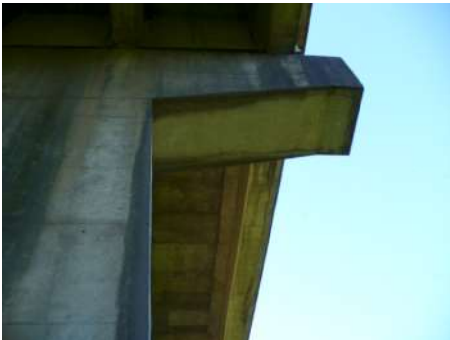
Situação generalizada: umidade pontual travessas, devido junta estar aberta.
