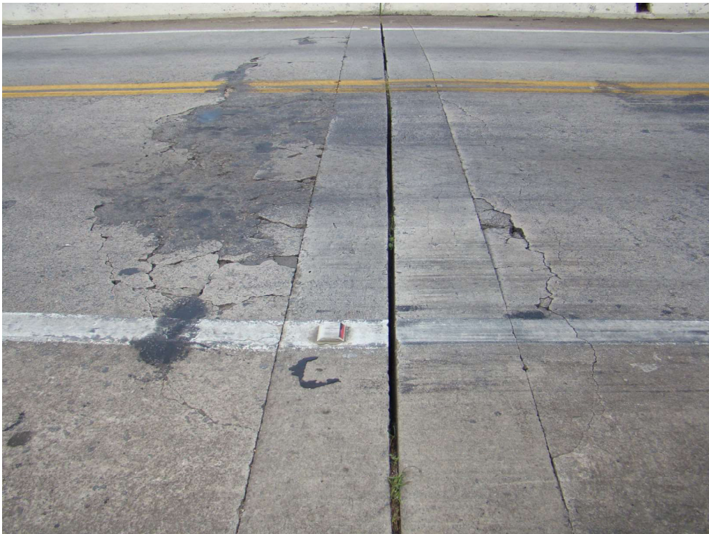
Figura 6 – Trincamento e desagregação na laje
