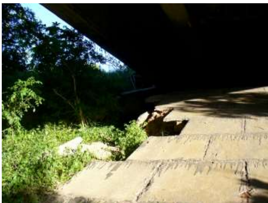
Solapamento proteção talude junto encontro Rio Grande.
