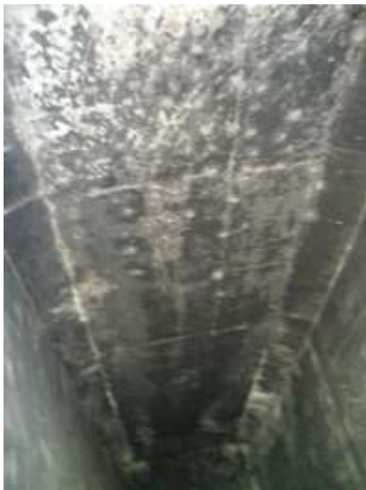
Detalhe lixiviação e excesso de umidade laje junto encontro Rio Grande
