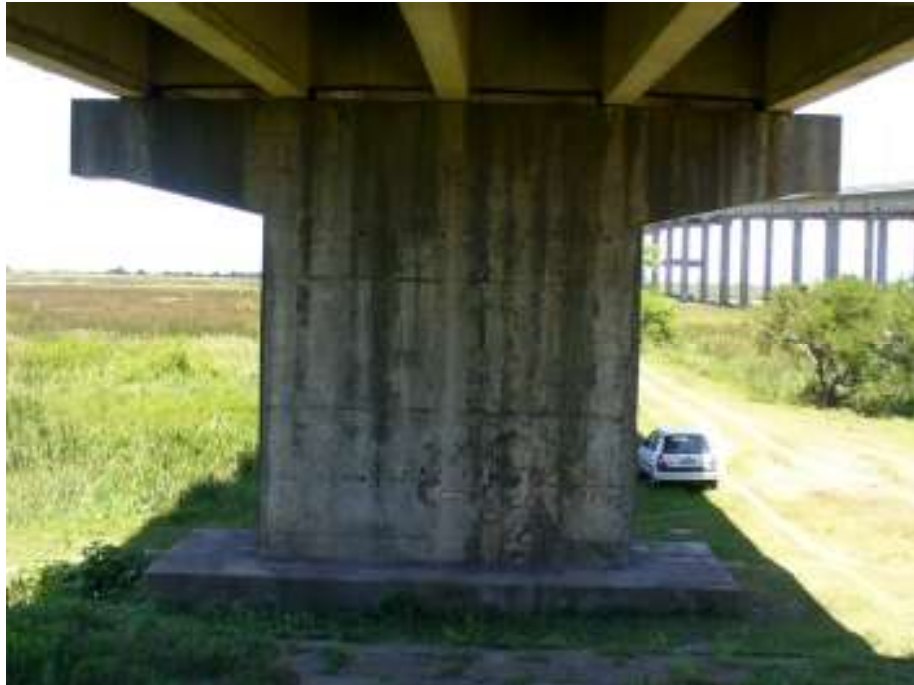
Umidade topo pilar P0100, devido junta aberta.
