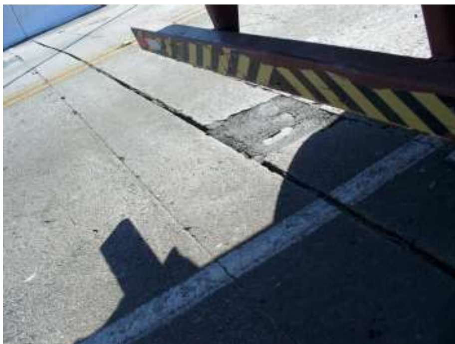
Detalhe junta sobre P1800
