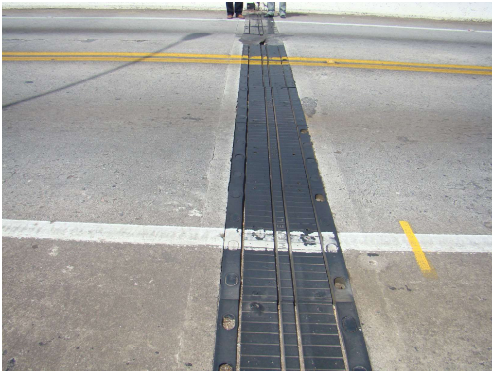
Figura 4 – Junta no vão central no lado de Pelotas (P10) a ser substituída (nota-se inclusive a ausência de um segmento)
