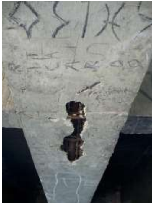
Falha de concretagem com armadura exposta V0004
