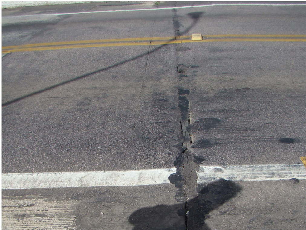
Figura 5 – Situação atual da junta no encontro do lado de Pelotas (E23)
