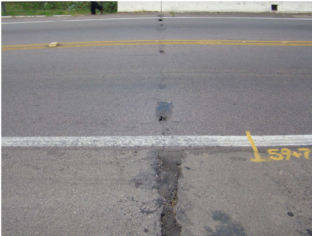
Figura 2 – Situação atual da junta no encontro do lado de Rio Grande (E00)
