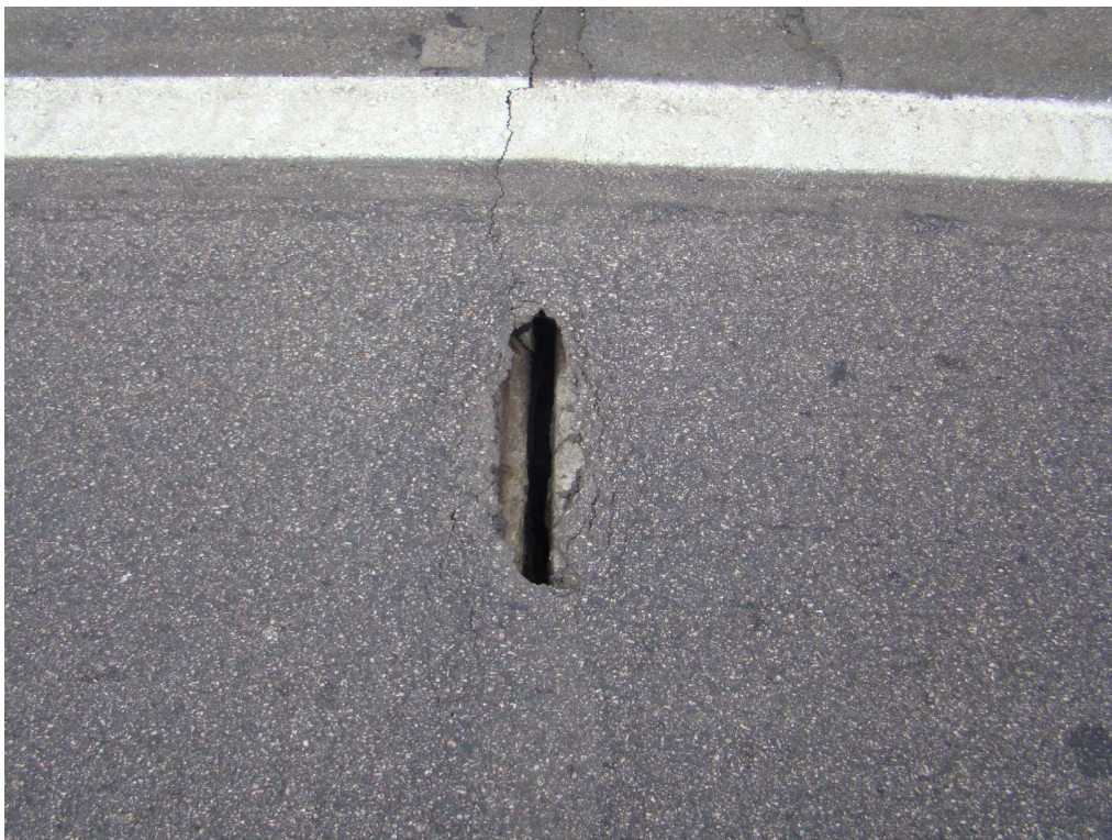
Figura 3 – Situação atual da junta no encontro do lado de Rio Grande (E00)
