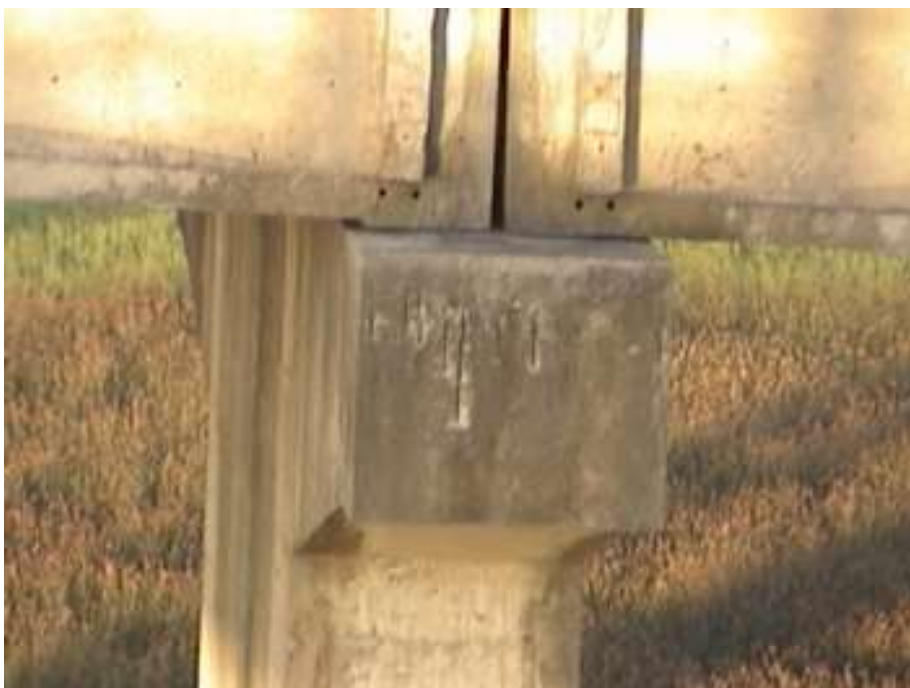
Situação generalizada: Fissura vertical face direita e esquerda das travessas
